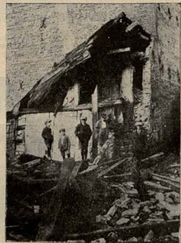
Zawalenie się domu w Warszawie: Dn. 3 bm. w Warszawie przy ul. Ogrodowej 63 zawalił się dom pozbawiając dachu kilka rodzin.
