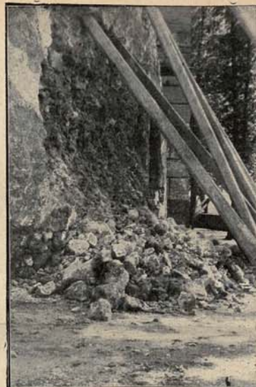
Oberwanie się ściany Muzeum etnograficznego: Podczas ostatnich ulewnych deszczów w Krakowie oberwała się część ściany budynku Muzeum etnograficznego na Wawelu. Mianowicie skutkiem podmycia ulewą, część słabego gotyckiego muru tej budowli, w miejscu, gdzie mur wznosi się pochyło obsunęła się odsłaniając wewnętrzne rumowisko, wypełniające ścianę budynku. Zagrożoną ścianę natychmiast podstępnowano silnie. W następstwie oberwania się ściany, zamknięto dla publiczności przejście okrzęne na Wawelu wzdłuż murów zewnętrznych od bramy wchodowej aż ku Smoczej Jamie.
